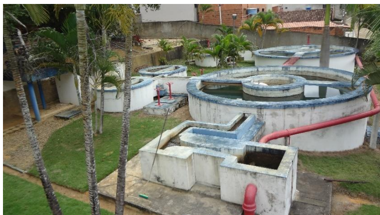
Figura 3-23– Estação de Tratamento de Água de Marilândia.
